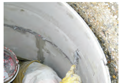
Stück für Stück werden die Tübbinge in den Schacht eingesetzt und mit Epoxidharz-Spachtelmasse verbunden.
